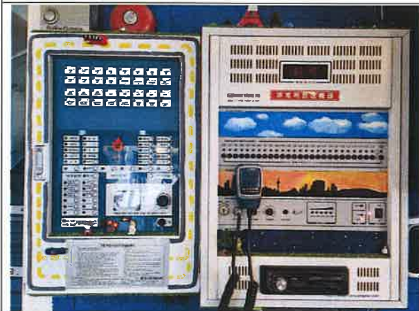
내용 : 소방시설 정상 작동. 양호
